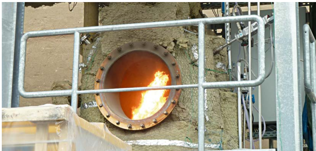
Nicht nur Lackabfälle, sondern auch Schleifstäube können in der Verbrennungsanlage in thermische Energie umgewandelt werden.
