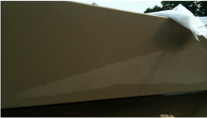
Bilder:Wasserflecken durch zu lange Lagerung in Folienverpackung
